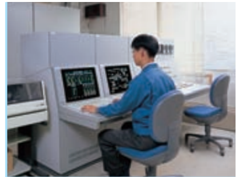
コントロールシステム室 CONTROL ROOM
